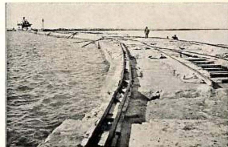
Obras del Puerto de Valencia — Efectos destructores de un temporal en el Dique Norte.
