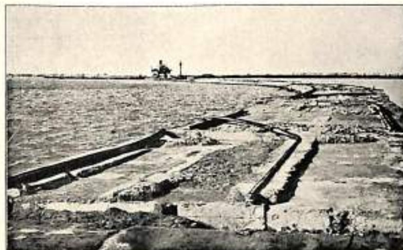
Obras del Puerto de Valencia — Efectos de un temporal en la superestructura del Dique Norte.
