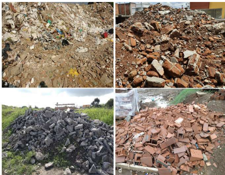
Figura 1. RCD pétreos: a) Sitio de disposición. b) Residuo de mampostería. c) Residuo de concreto. d) Retales de ladrillo
