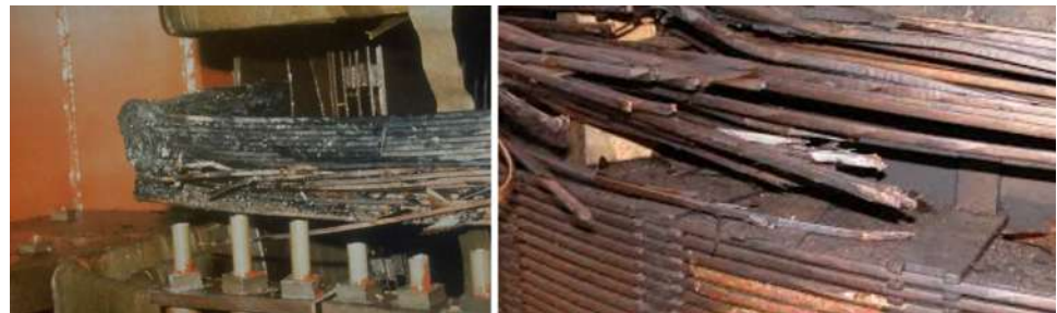
Figura 6. Daños en transformadores asociados a tormentas geomagnéticas. A la izquierda, daño permanente en el transformador de la Planta Nuclear de Salem durante la tormenta del 13 de marzo de 1989 ( Thompson et al. , 2010 ). A la derecha, un transformador en Sudáfrica que falló semanas después de la tormenta de Halloween de 2003 (Crédito: PSE&G).
